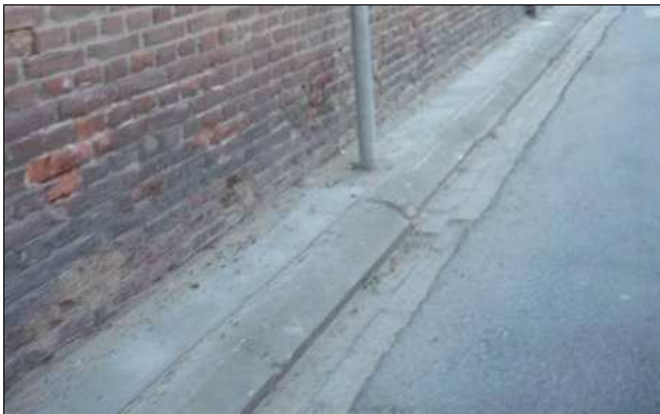
Figure 543 : Photographie d'un trottoir étroit, ruelle Altache, Rebecq
